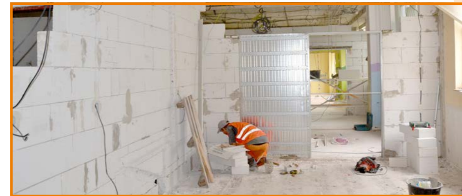
V rámci rekonstrukce dětského pavilonu MNUL budují dělníci nové ambulance pro malé pacienty
